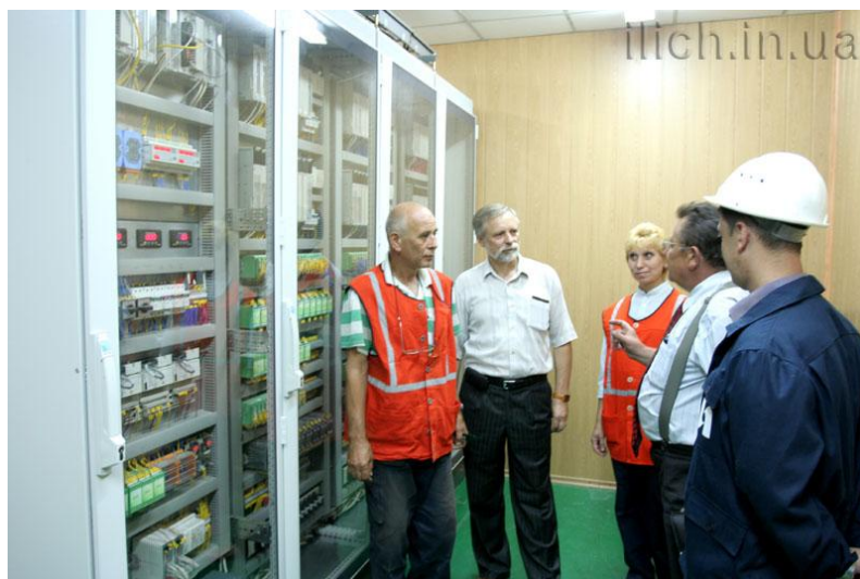
Рис. 3. Начальник служби автоматики та зв'язку залізничного цеху ММК ім. Ілліча Мельниченко Г.Б.(другий праворуч) та генеральний директор «Іпра-Софт» Романчук В.Б. (другий ліворуч) в «релейному приміщенні» ст. Стальна-Сляб біля шаф підсистеми нижнього рівня після здачі системи МПЦ у постійну експлуатацію
